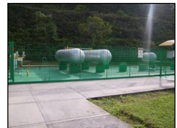
Central de gás
