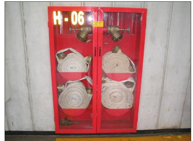
Hidrantes – Tipo Parede.
